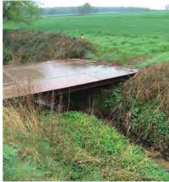
Photo 1 : Exemple de passerelle (source : Guide sur les travaux en cours et zones humides – DDT de l'Allier)
